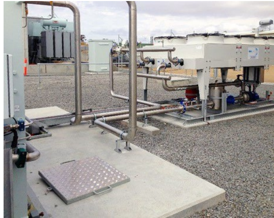
Fin fan cooler
